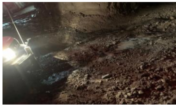
Figure 3 : Etat de la route
